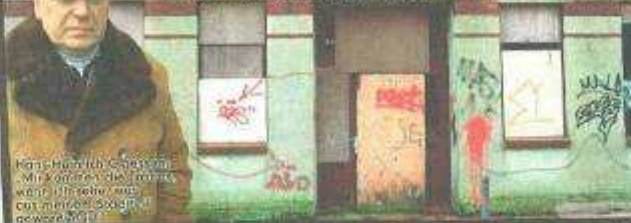
Bretter vor den Fenstern. Schimmel in der verwitterten Mauer. Das Haus an der Zollnordstraße steht leer.
