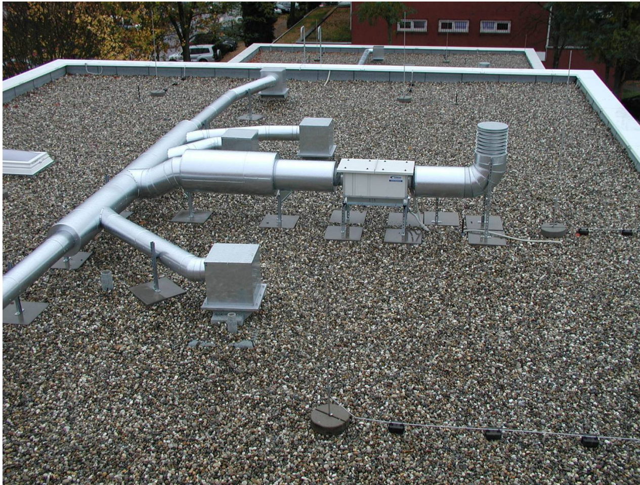
Abluftanlage auf dem Flachdach
