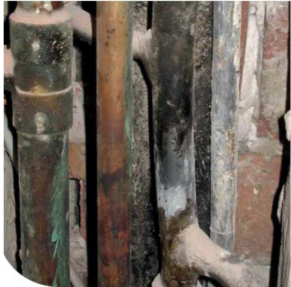
Steigleitung aus Blei (rechts) neben Rohren aus anderen Materialien
