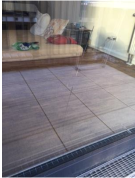
Riss in Fensterscheibe
