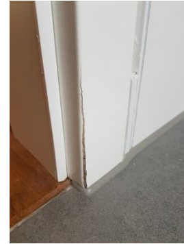
Aufgeschwollene Türezarge Bad
